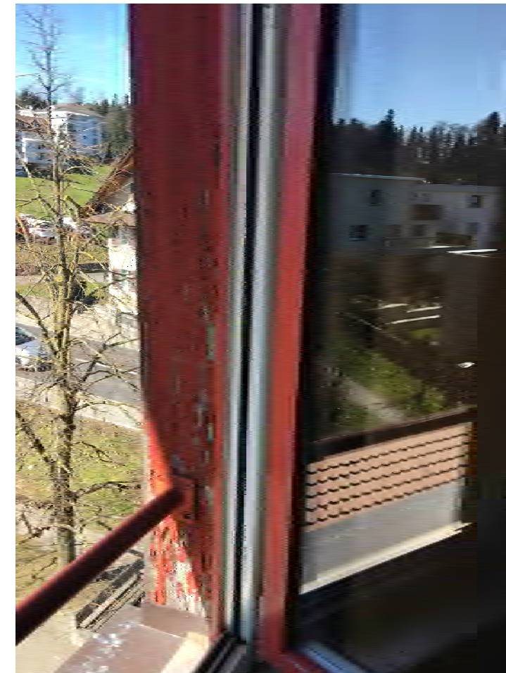
Holzteile mit defektem Anstrich
