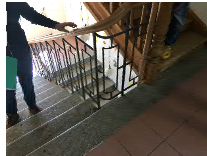
Treppengeländer entspricht nicht mehr den heutigen Sicherheitsaspekten
