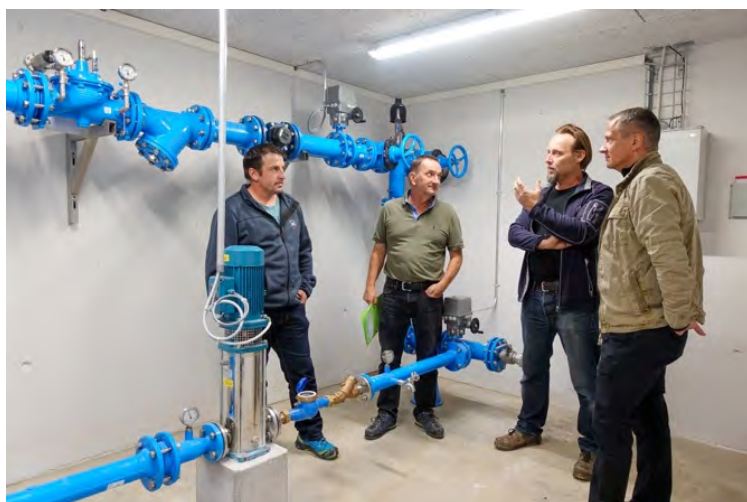
Die Vorstandsmitglieder Martin Hess, Teddy Krauer, Edgar Krummenacher und Roger Hogg im neuen Pumpwerk der Wasserversorgung Hellbühl. Auf dem Bild fehlen die weiteren Vorstandsmitglieder Fritz Schweizer und Marcel Schmid.
